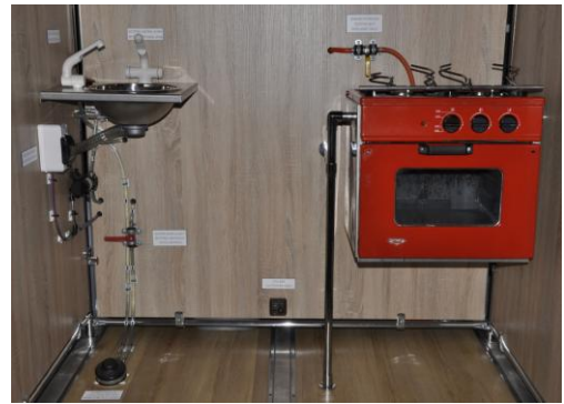
Fot.1. Model kambuza. Instalacja zasilania w wodę słodką zimną, ciepłą i zaburtową
