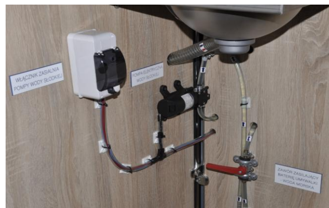
Fot.5. Odprowadzenie ścieków do zbiornika fekalii, pompa elektryczna 12V wody słodkiej, włącznik zasilania pompy, zawór odcinający zasilanie baterii wody zaburtowej
