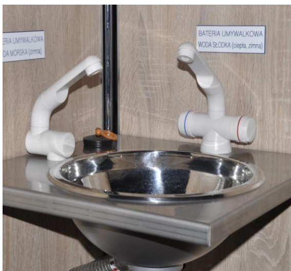
Fot.4. Nierdzewny zlewozmywak, bateria z wodą zaburtową, bateria z wodą słodką zimną i ciepłą
