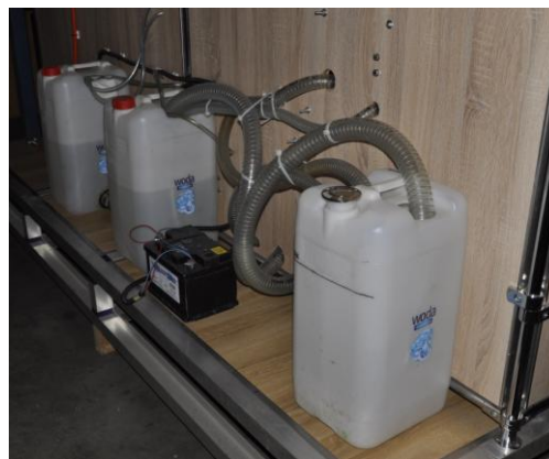
Fot.1. Stanowisko modelowe instalacji ściekowej i wody słodkiej. Zbiorniki
